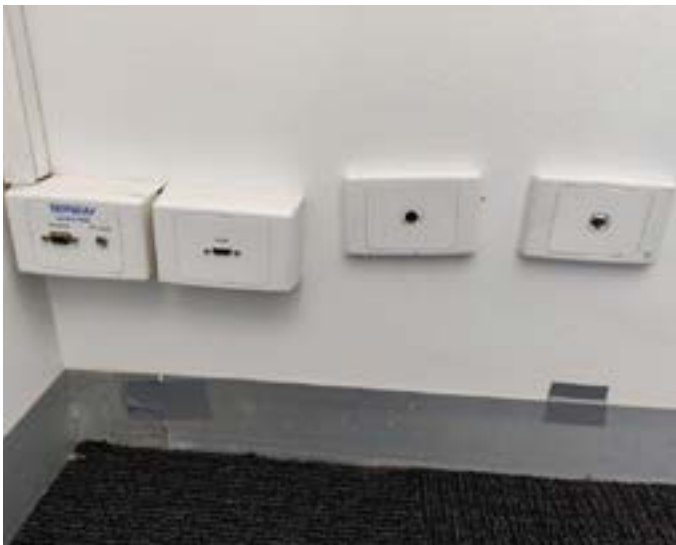
AV wall inputs
